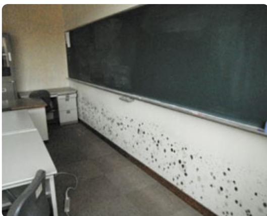
漏水によりカビが発生
