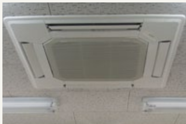
空調機取替後
