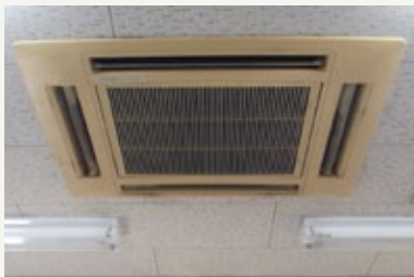
空調機取替前
