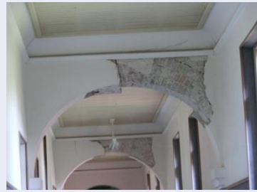
五高記念館の廊下の漆喰が崩落
