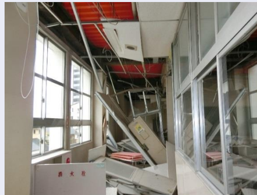
附属小学校廊下の天井崩落
