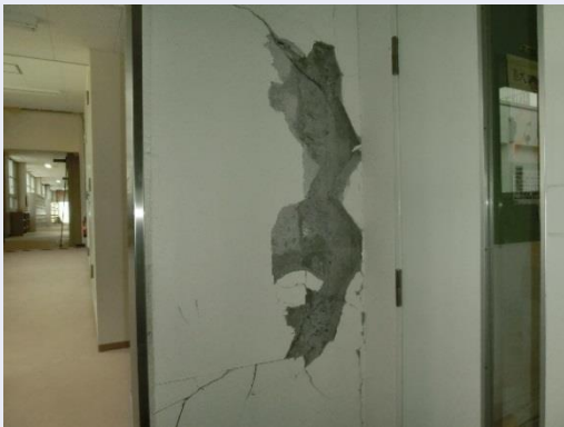
柱のひび割れ
