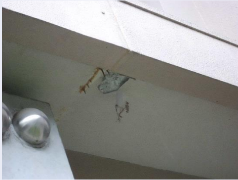
外壁の剥がれ
