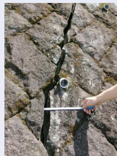
擁壁法面のひび割れ
