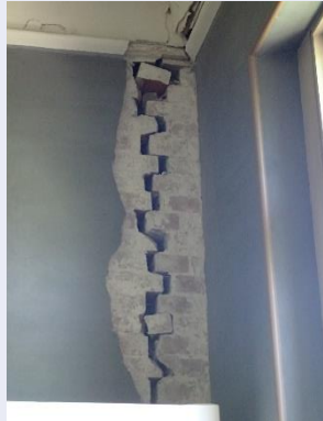
五高記念館北側壁の亀裂
